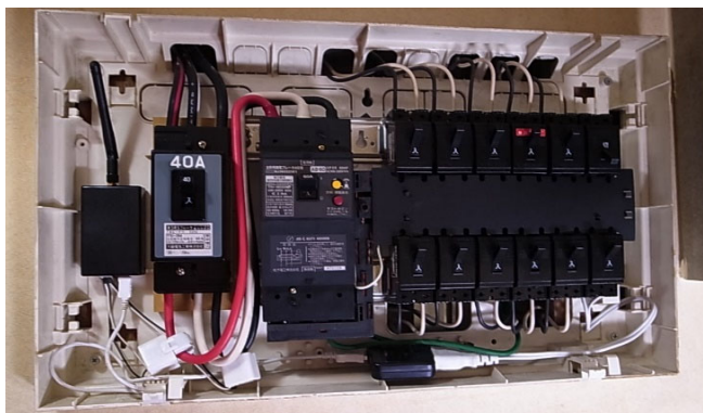
配電盤 (家庭用)
